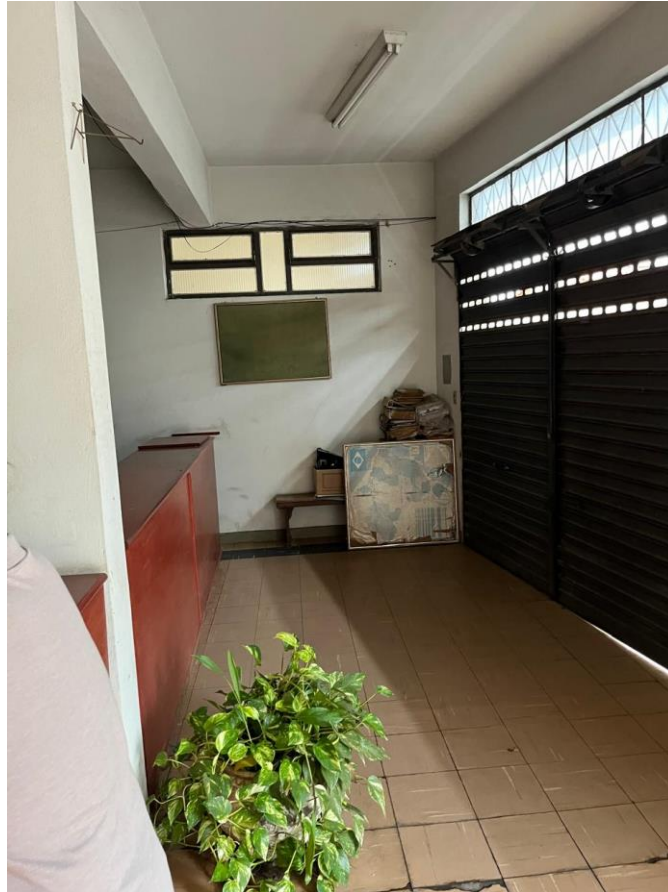
Registro 05: Pintura das paredes internas e lâmpada queimada.
