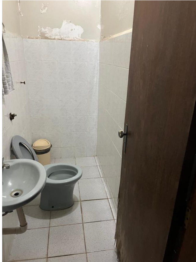
Registro 02: Registro das condições da porta e pintura do sanitário 2.
