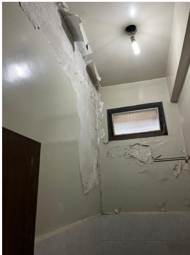
Registro 03: Registro das condições da pintura do sanitário 1.
