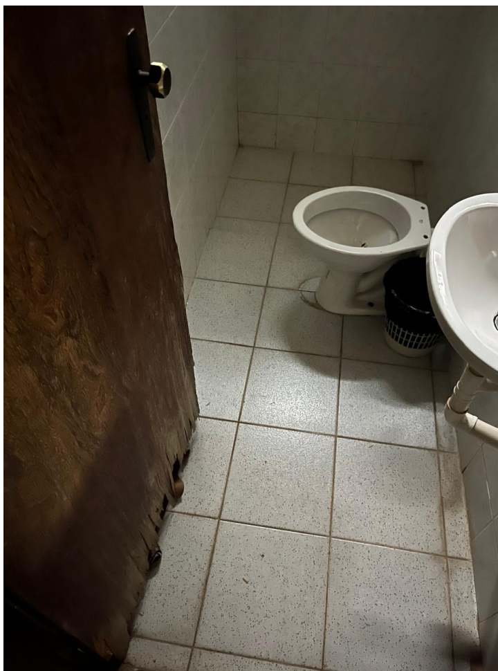
Registro 01: Registro das condições da porta do sanitário 1.
