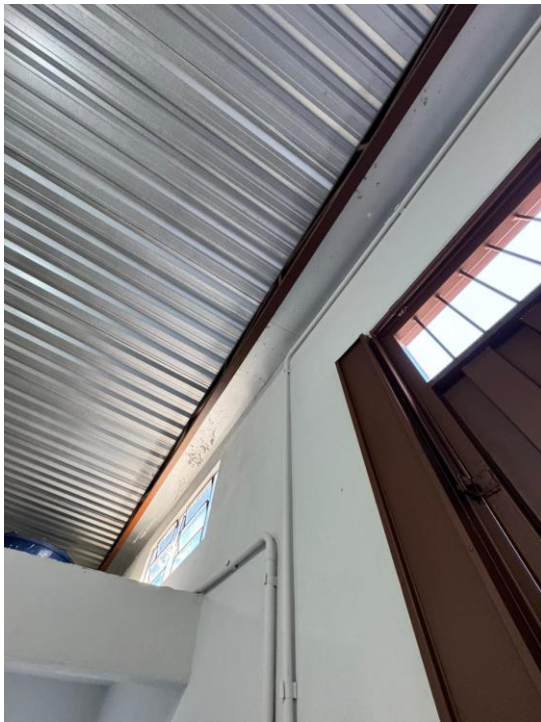
Registro 02: Calha frontal com sinal de infiltração na junta.
