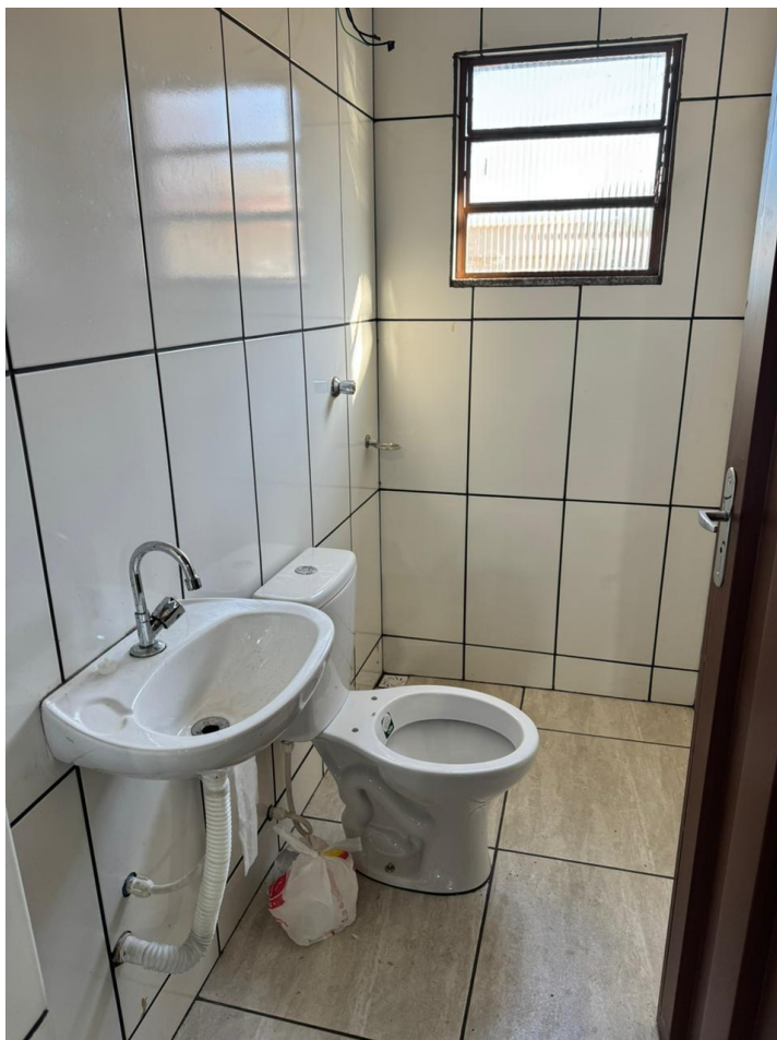
Registro 01: Registro das condições do sanitário.
